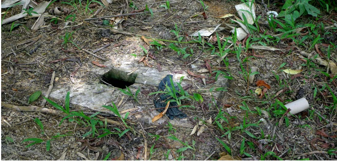
Fotografía B1.4.7 Letrina autoconstruida sin caseta en el Barrio de Santa Rosa. Autor: Gonzalo Muñoz Bartolomé.
