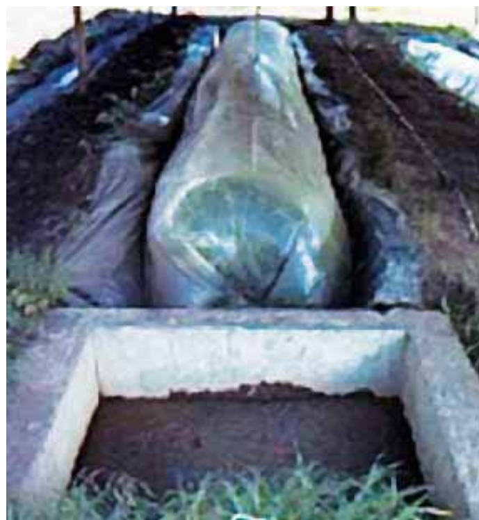
Fig. 9.31-. Biodigestor instalado y en funcionamiento Fuente: Elaboración propia
