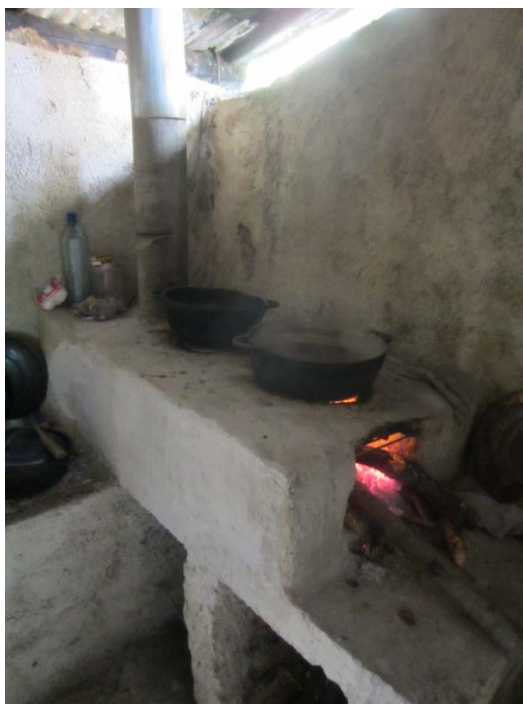
Fig. 9.17-. Cocina mejorada modelo CETA en funcionamiento
