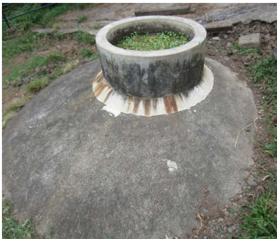
Fig. 9.37-. Biodigestor de estructura y cúpula fija conectado a establos
