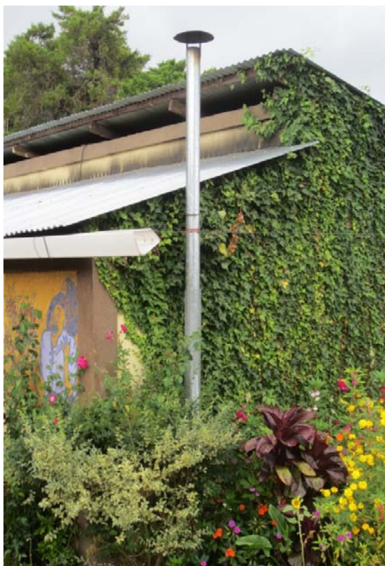
Fig. 9.35-. Salida de humo al exterior de las viviendas
